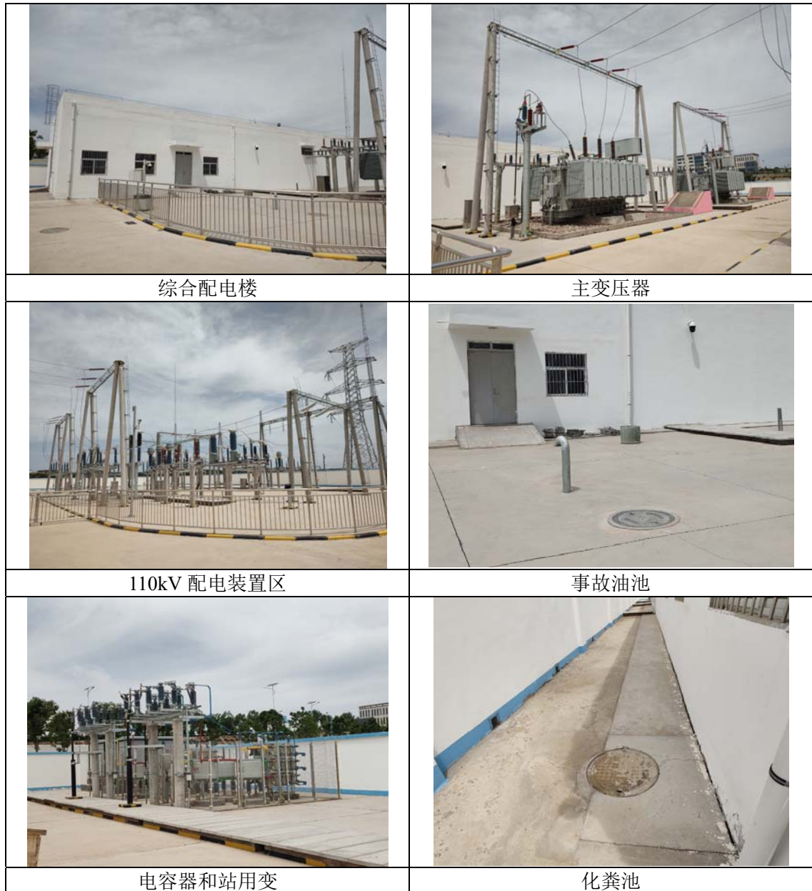
图 2-1 小南沟 110kV 变电站现状图
