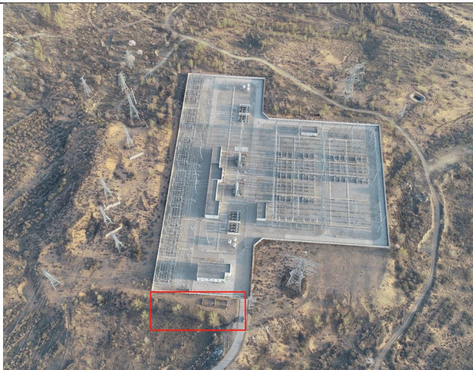
线路起点麟州330kV变电站出线间隔位置
