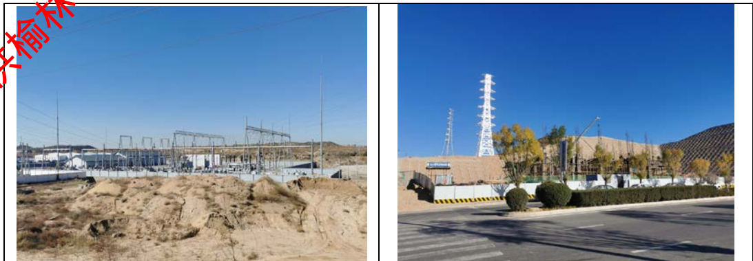
白云220kV变电站出线处（线路起点）
