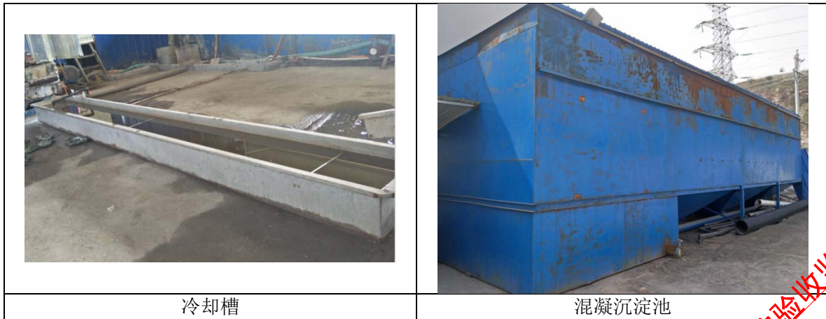
图4.1.1-2项目废水处理设施现场照片
