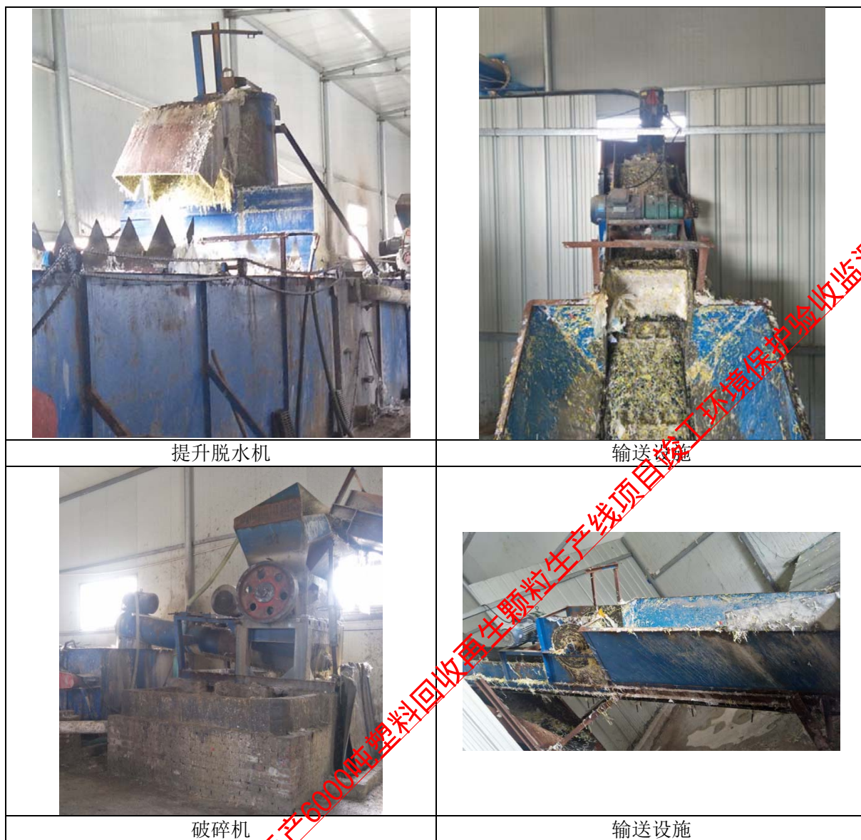
图4.1.3-1厂区及厂房内设备布置现场照片
